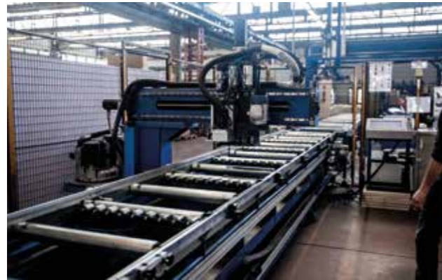
Impianto lavorazione pannelli. Panel processing plant.
