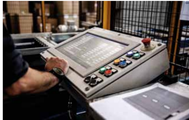
Sistema di controllo automatizzato. Automated control system.
